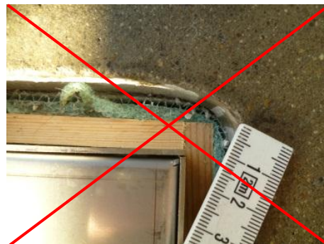
Bei so ausgebildeten Ecken kann sich der Estrich nicht mehr spannungsfrei bewegen. Risse sind zu erwarten.
