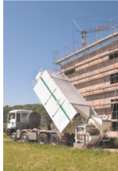
Misch- und Förderanlage unseres Lieferanten
